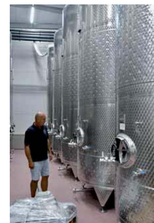
Sklep mistr křížového sklepa v Příměticích Petr Drozd dohlíží na instalaci nové technologie
